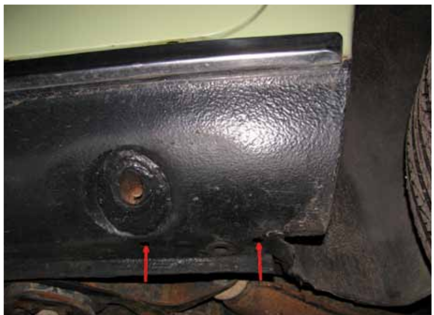
Roststelle ②: Fehlen hier die Wasserablaufbohrungen, wurde gepfuscht.
