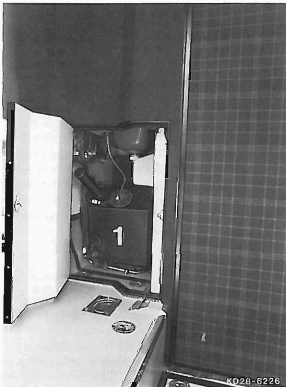
1 Wassertank für das Handwaschbecken
